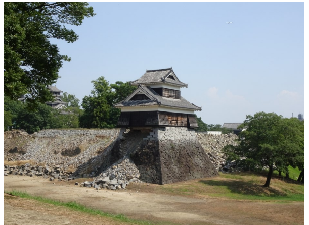
熊本城石垣崩壊
